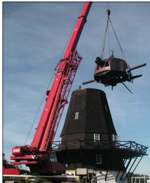
2009. En stille septemberdag blev den løgformede møllehat, nu beklædt med kobber, sat på plads. Et skønt syn.
